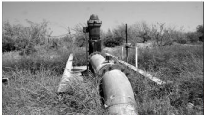
Control. La Conagua colocará medidores volumétricos en 24 pozos industriales de la región lagunera.
