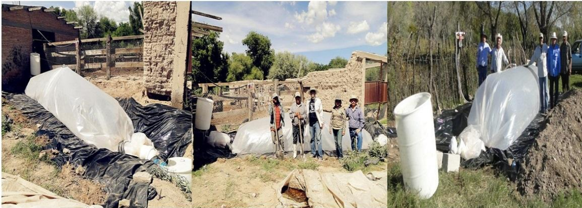
Fig.4.36 Instalación de biodigestor en Nazas, Durango, con el fin de disminuir la contaminación por nitratos y, a la vez, generar energía. Fotografías del Consejo de Cuenca Nazas Aguanaval.
